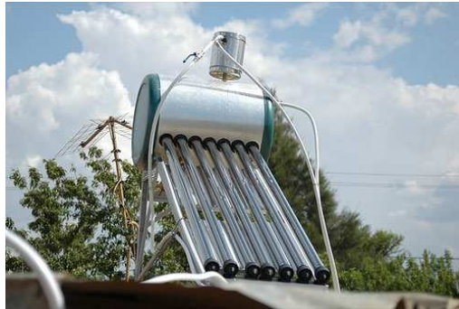
'n Son-waterverwarmer op die dak van 'n huis. Die water is in die tenk. 4
